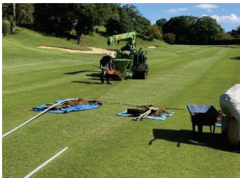
植栽基盤排水改善工 シートパイプ工法 効用: CO 2 抑制、雨水流出抑制
